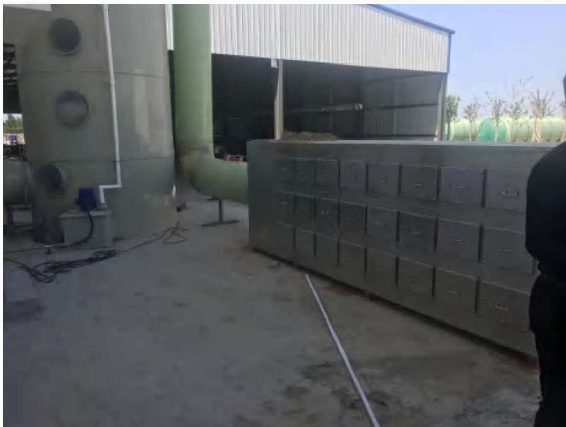
图 3-1 废气治理设施现场图
